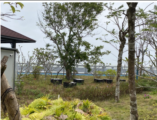
珊瑚岛停车区地埋一体化污水处理设施
