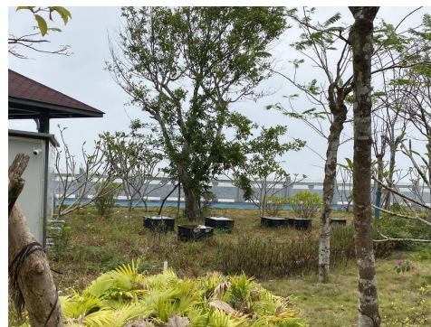
地埋一体化污水处理设施
